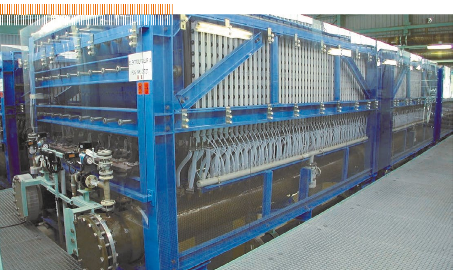
Chlor-Alkali-Elektrolyse in Hürth-Knapsack: 310.000 t Chlor pro Jahr, 203.000 Nm 3 Wasserstoff pro Tag
